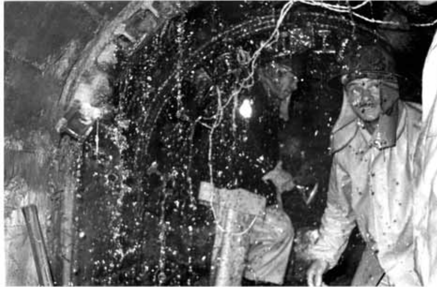
La imagen fue captada en Tapantí tras haber ocurrido un derrumbe parcial del túnel por efecto de la presión del agua. Dionisio León (de frente,) perdería la vida poco después, a 300 metros de este sitio, al caer sobre su pecho una enorme masa de material.
