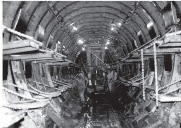
Las estructuras de metal que se observan son formaletas que serán removidas una vez que el concreto haya endurecido y tomado su forma definitiva.
