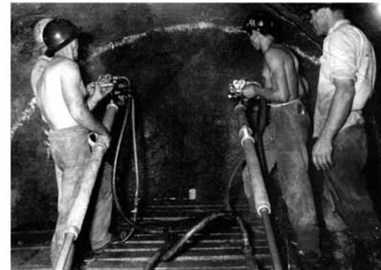
Tuneleros perforan la roca con dos máquinas de "pie de empuje tipo "jack leg". Están parados sobre un andamio, lo que les da acceso a la parte superior del tope. (P.H. Río Macho).
